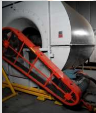
Fig-1 ASU Centrifugal Fan and Motor.
