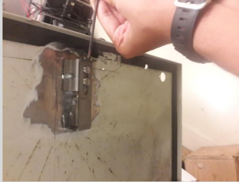
Fig 4 : Door Lock (After)
