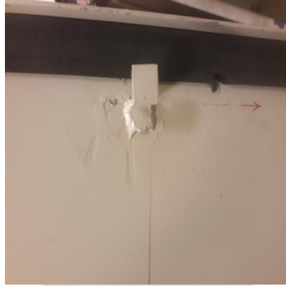
Fig 3 : Door Lock (Before)
