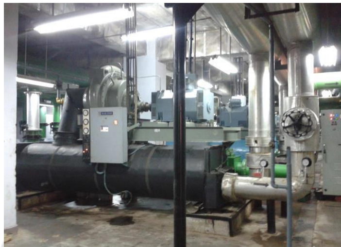
Fig:2 CHW chiller[3]
